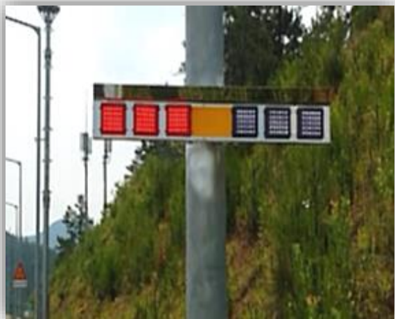
갓길 설치(가로등 충전식)
